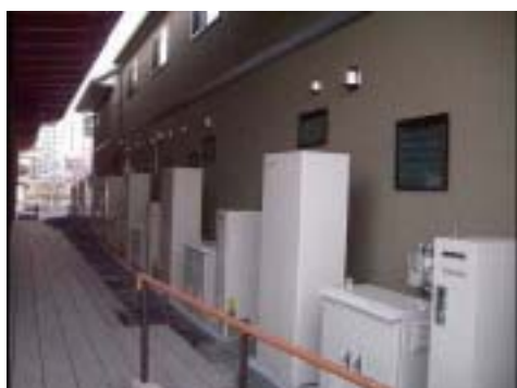
北九州水素タウン内の集合住宅に設置された純水素型燃料電池
